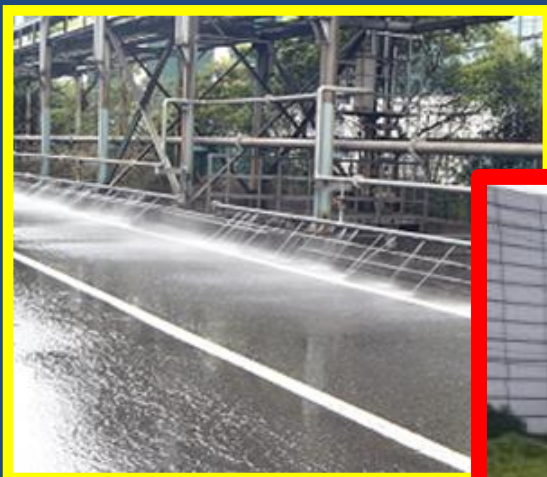
昨年度設置 構内道路散水
